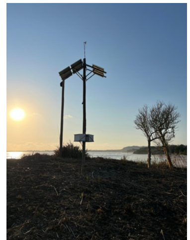
Proyecto Energético Instalado
