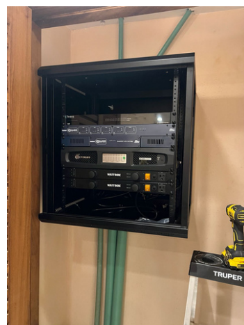
Gabinete de Comunicaciones
