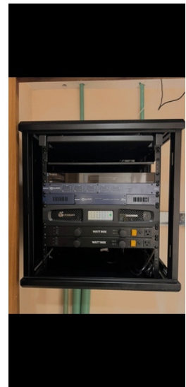
Rack de Audio y Control
